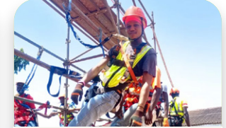
Mobilfunkmasten und solare Infrastruktur (Ghana)
